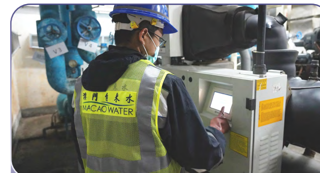
停電事故演習 Exercício de simulação de corte de electricidade Power outage drill
